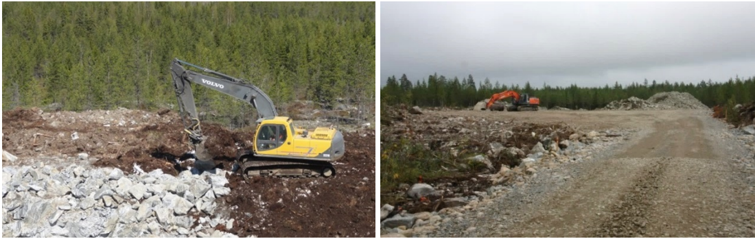
Kuva 23. Tuulivoimapaiston rakentaminen alkaa huoltoteiden ja pystytysalueiden rakentamisella (kuvat: FCG).
